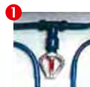
Impianto antincendio montato sulla conduttura
